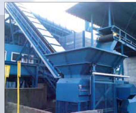
Tramoggia di carico
