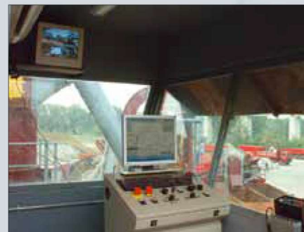
cabina di comando con sistema di gestione
