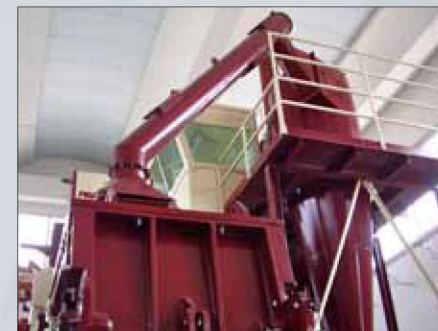
impianto di aspirazione
