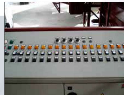
consolle di comando | control panel
