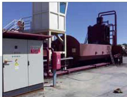
quadro elettrico | switchboard
