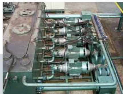
impianto oleodinamico | control panel
