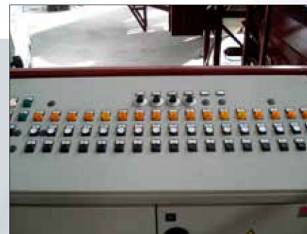
consolle di comando | control panel
