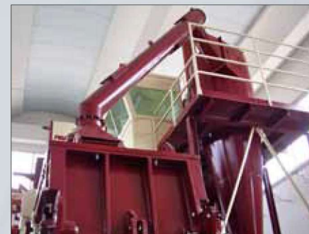
impianto di aspirazione
